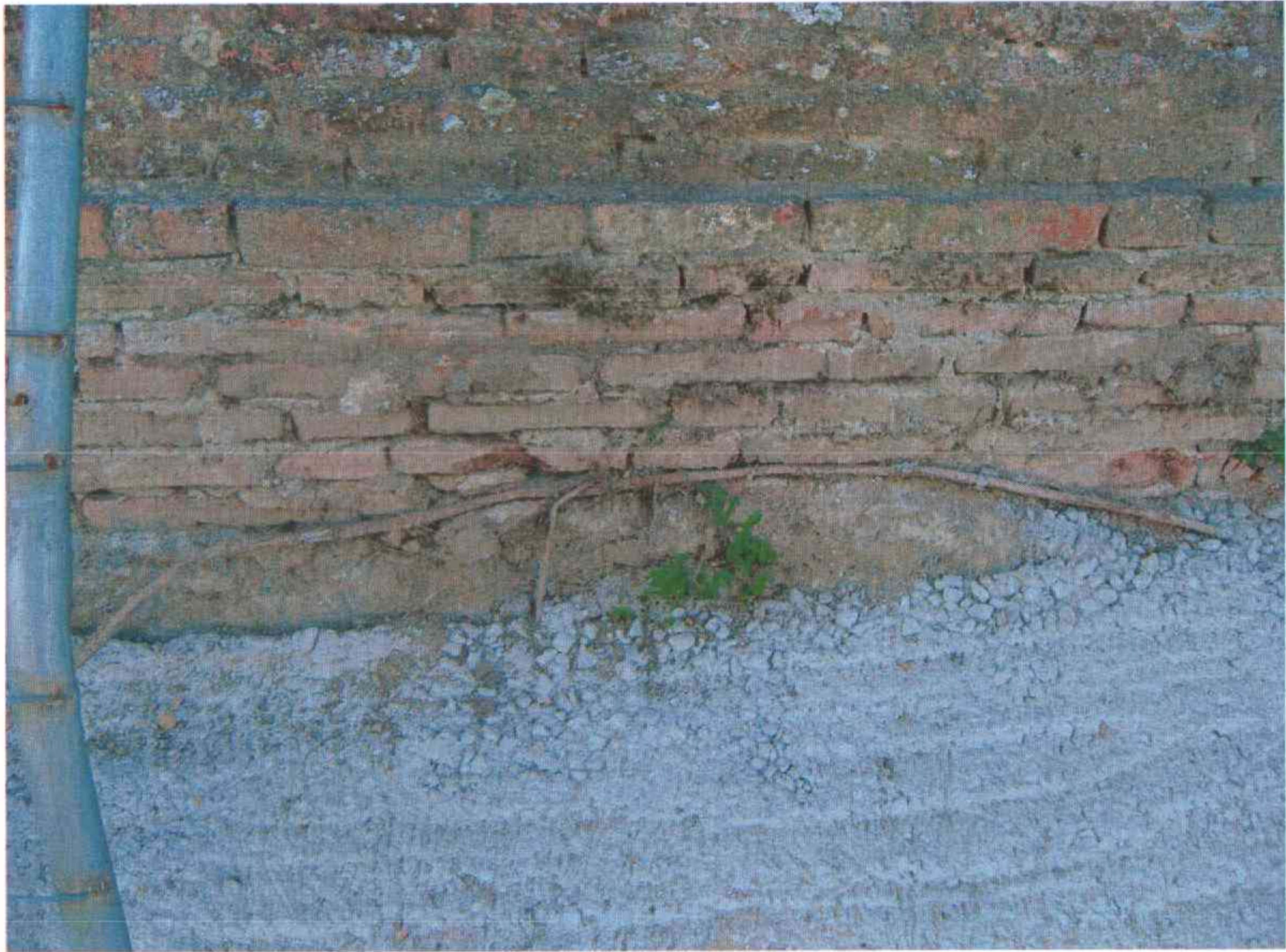
Detalle arranque muro sin cimentación (2)
