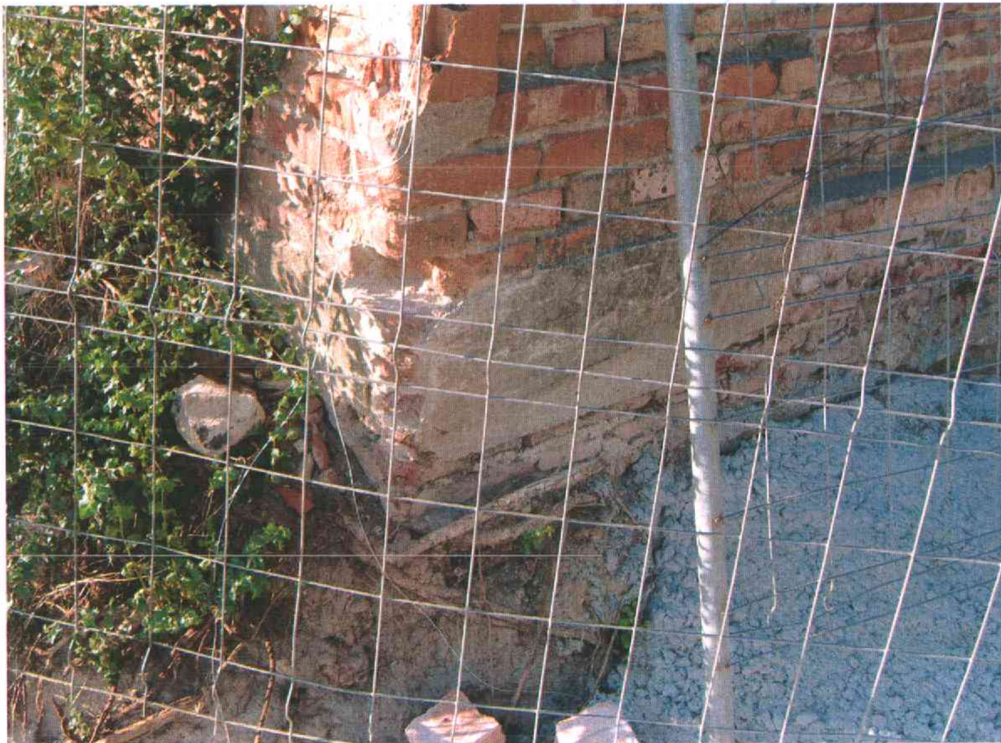
Detalle arranque muro sin cimentación (1)
